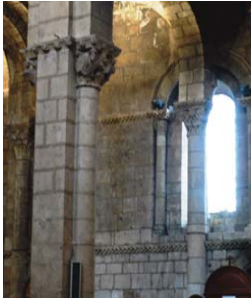
FIGURA 29. Anomalia existente en el interior de la Colegiata de San Isidoro de León (un pilar de la estructura interior en medio de una ventana del muro precedente).
